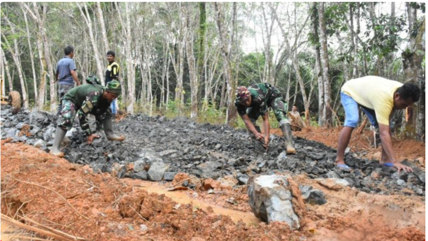
Percepat Pengerjaan Jalan, Material Dan Alat Terus DiKebut Satgas TMMMD Ke 116 Kodim 1004 Kotabaru
